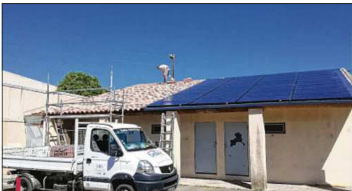
Sur les toits de trois bâtiments municipaux (ici le vestiaire Sanchez du gymnase Tourrier), 90 panneaux solaires ont été installés.
